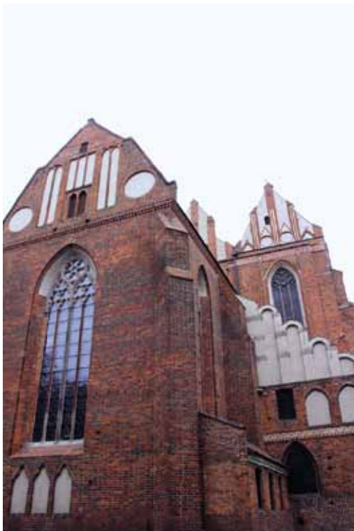
Das Gotteshaus wäre ein Gebirge, hätte es die Fenster nicht – als Erleuchtung: Ost-Chorfenster der Johanniskathedrale mit neuer Außenschutzverglasung, Februar 2016
